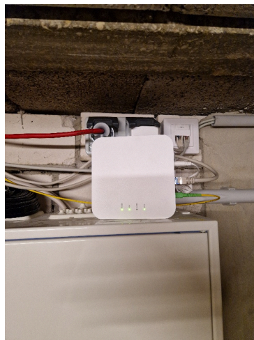
Abbildung 2: Medienkonverter im Keller auf dem Schaltschrank
